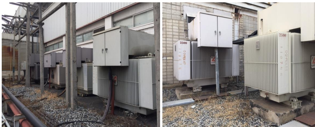
ภาพที่ 2.12 หม้อแปลงไฟฟ้า
