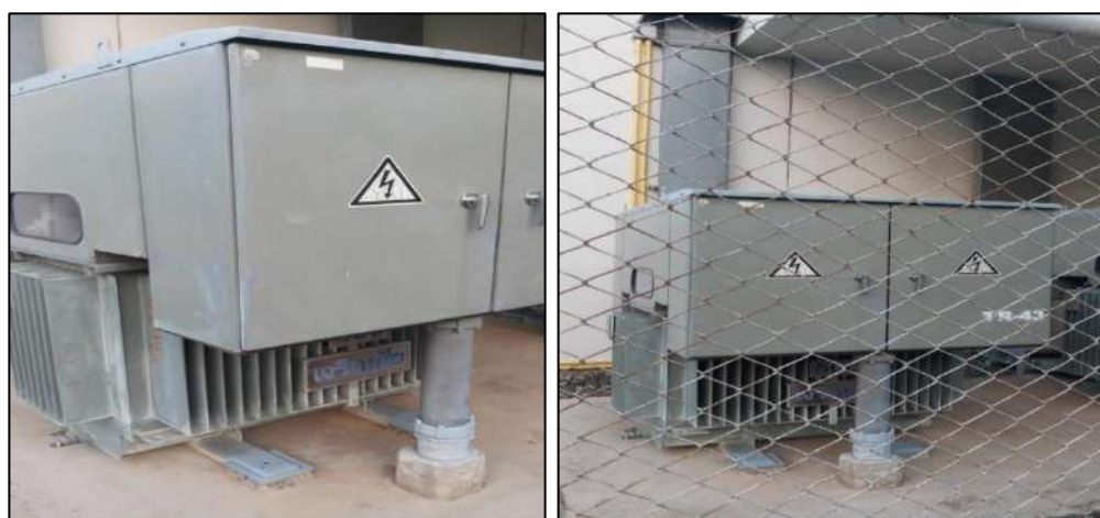
ภาพที่ 8 หม้อแปลงไฟฟ้า
